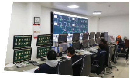
中央控制室 Central control room
